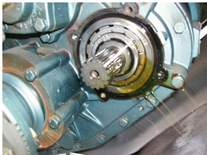
Coperchio rimosso. Cover removed.
